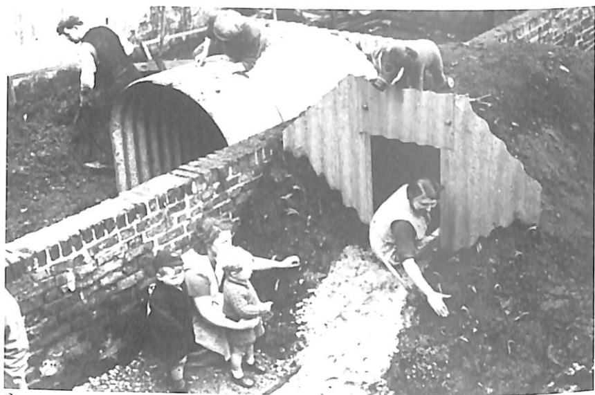
2. ミュンヘン危機の後、イギリス市民は自宅の裏庭に 「アンダーソン」防空シェルターを設置した
